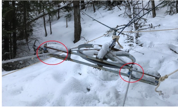
Slitasjepunkter på trekktau pga. vendehjulets plassering i K40 (1.08.087)
